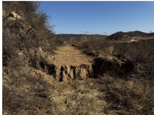
丈招路西侧耕地生产道路受损
