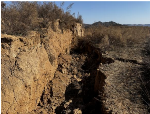
丈招路西侧耕地裂缝、塌陷现状
