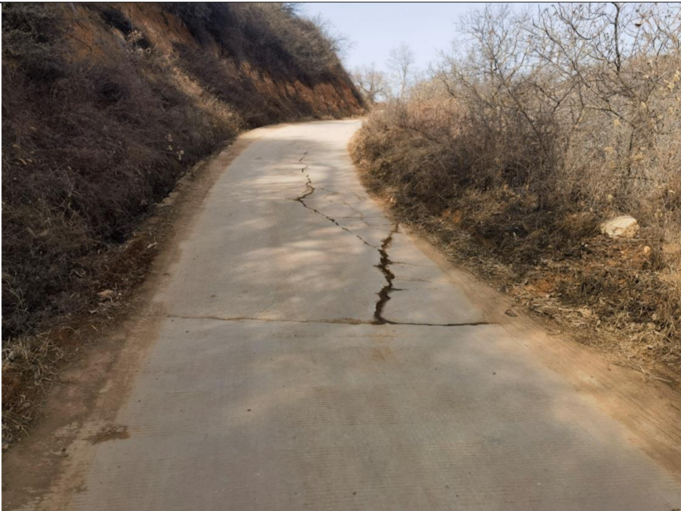
待修复路面现状 1（拍摄时间：2026.1）
