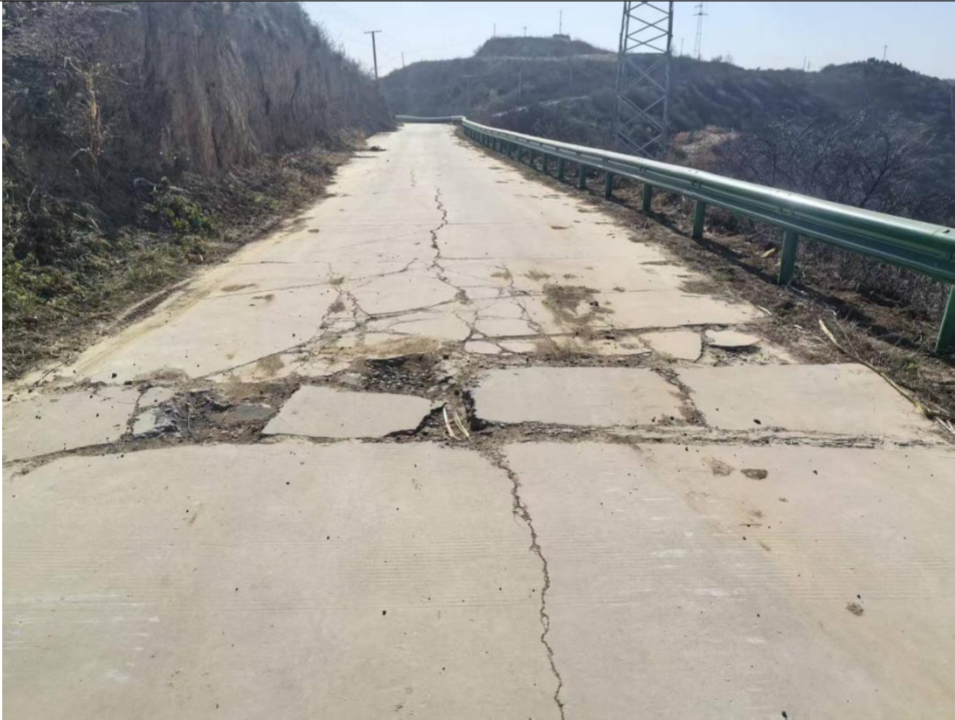
待修复路面现状 2 (拍摄时间: 2025.12.12)
