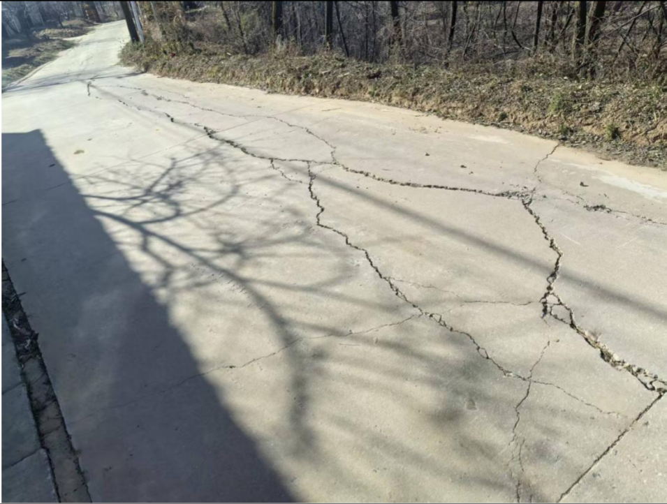
待修复路面现状 1 (拍摄时间: 2025.12.12)
